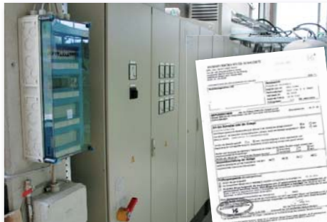
Revision der elektrischen Anlagen mit Befundschein gemäß Kl. 3602 und den Richtlinien VdS 2871 durch einen VdS-anerkannten Sachverständigen
